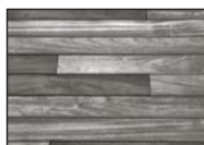
Bois après 6 mois sans traitement
